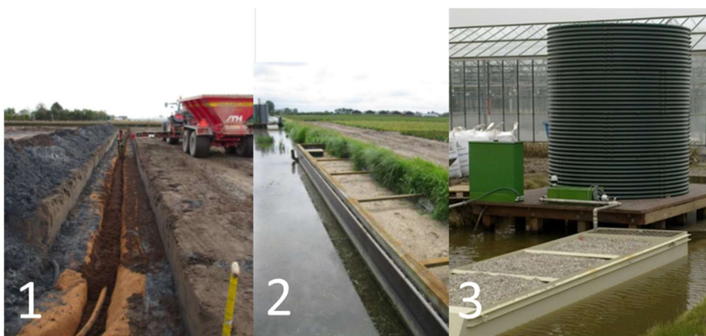
Figuur 0-5: Drie vormen van fosfaatverwijdering met ijzerzand getest bij een bollenteler in Voorhout: (1) Drain omhuld met ijzerzand; (2) Behandeling met een ijzerzandfilter langs de oever; en (3) Reactor met ijzerzand.
